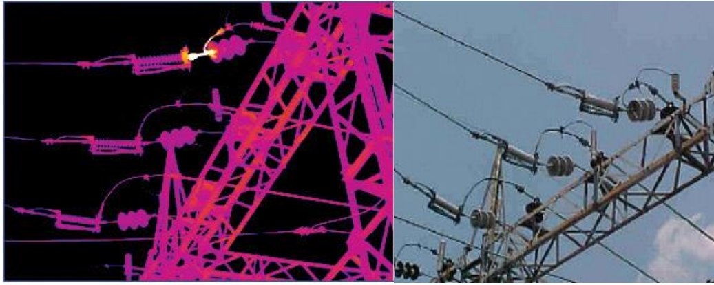
Рис. 1.2 Виявлення „гарячого” з’єднання в підстанції за допомогою тепловізора
