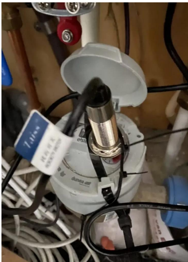
Рисунок 19 приклад закріплення датчика наближення до лічильника
